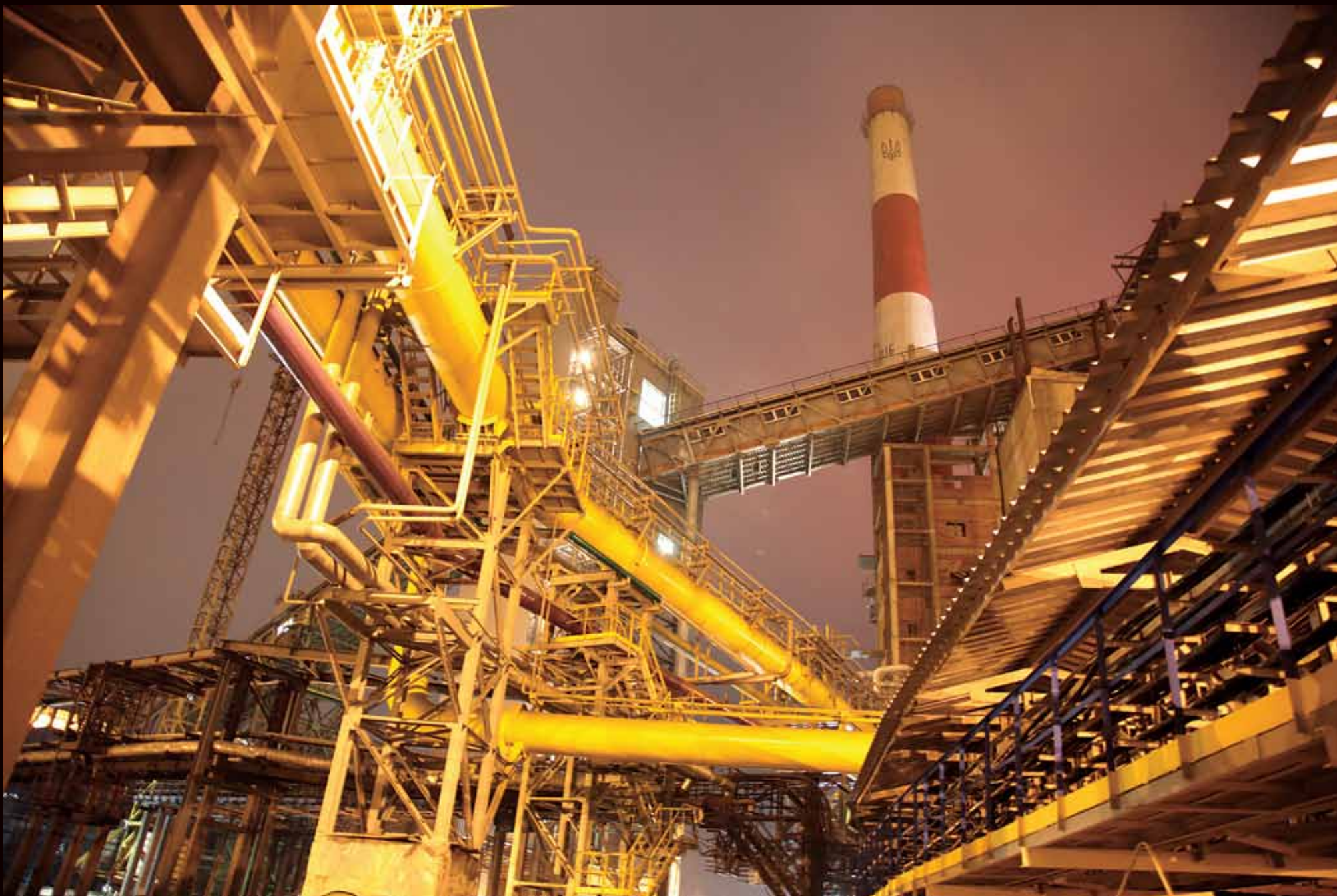
Коксові батареї №5, 6 ПАТ «АрселорМіттал Кривий Ріг» • Coke batteries №5, 6 of the AMKR (ArcelorMittal Kryvyi Rih) public corporation
